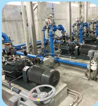
上山統合ポンプ場
