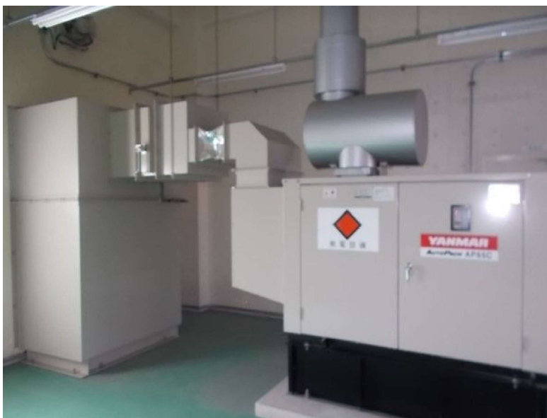
壱町田統合ポンプ場 自家発電設備
