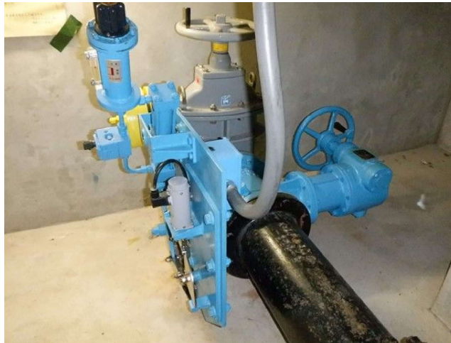
武豊第2配水場 緊急遮断弁
