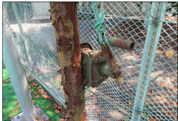
図 3-12 矢道[防矢ネットハンドル](腐食・操作不能)
