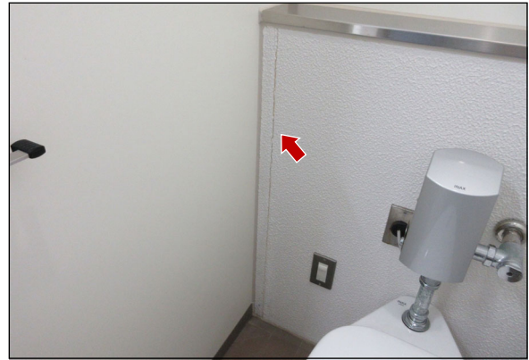
図 3-18 プール(男性用トイレ)[壁](亀裂)
