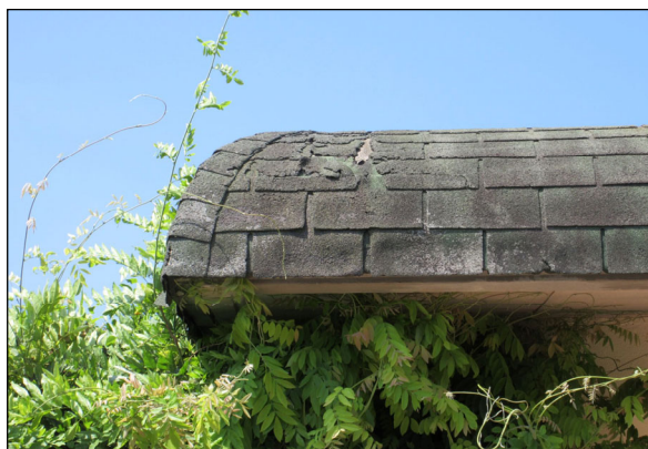
図 3-5 管理棟[屋根](屋根材剥離・腐食、樹木浸食)
