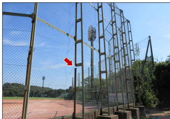
図 3-8 バックネット(支柱の錆・破損)
