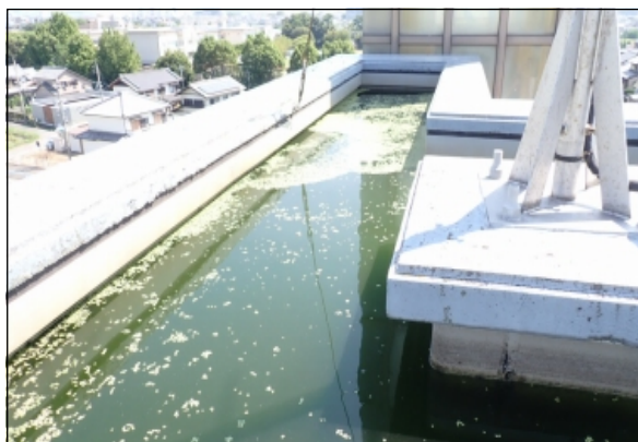
図 3-1 エレベーター機械室[屋上](排水不良)
