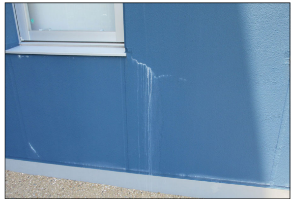
図 3-20 建物[外壁](亀裂・白華(エフロレッセンス))
