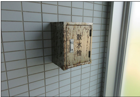
図 3-19 プール[散水栓箱](錆)
