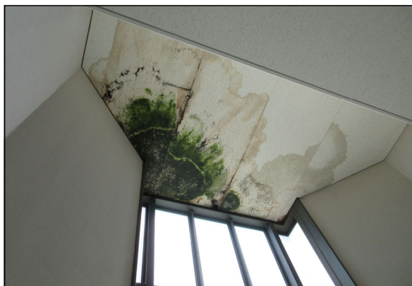
図 3-3 階段D踊り場[天井](漏水・カビ)
