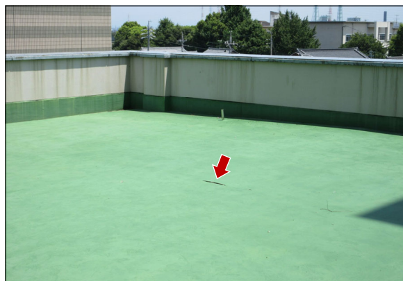
図 3-2 3階視聴覚室前[屋上](防水シート亀裂)
