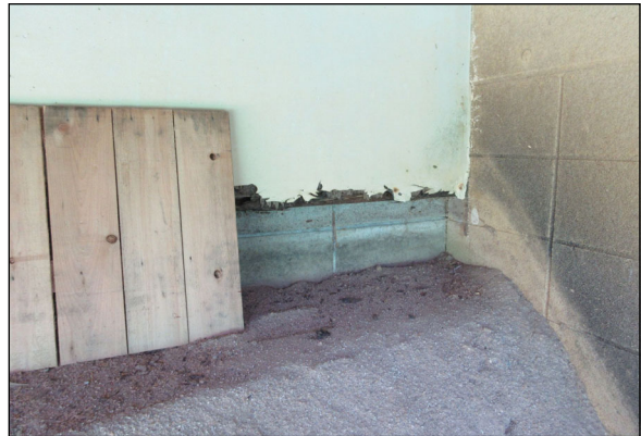
図 3-10 的場[安土](蟻害)
