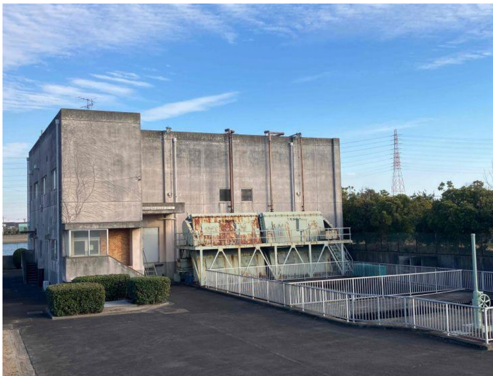
施設の老朽化が顕著な 大足第1ポンプ場
