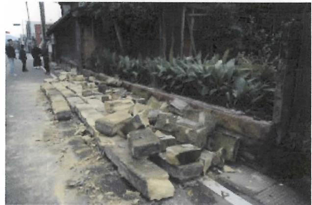
倒壊した民家のへい＝石川県輪島市風上町で、25日午後2時53分、八田浩輔撮影
