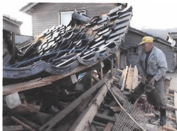
地震で倒壊した木造家屋＝石川県輪島市門前町で26日午後4時58分、望月亮一撮影
